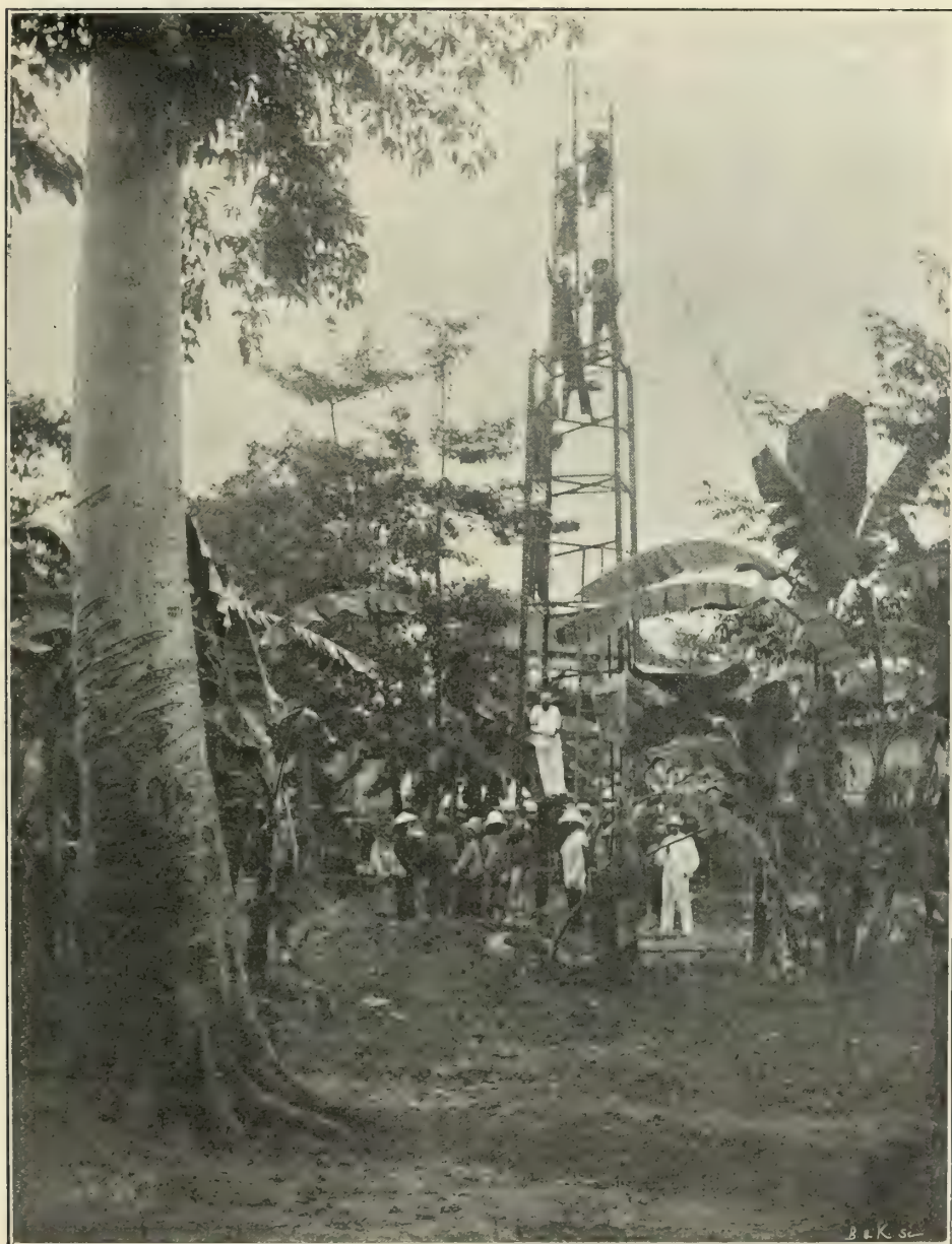
Fig. 70. — Construction d'un support en fer pour la traversée du fleuve du Lac par le fil télégraphique.
